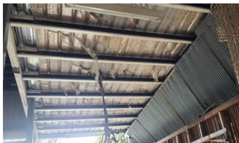
長廊空間天花板老舊
