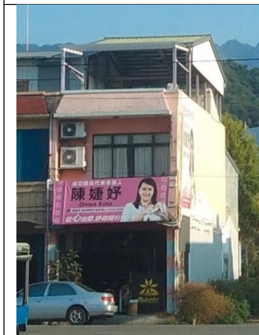
建築外牆油漆褪色、脫落
