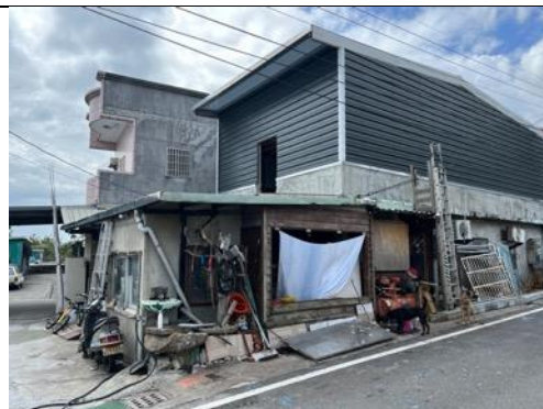
建築側面開口破損
