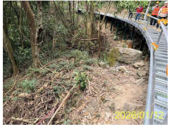
裸露地部份未覆蓋或進行排導水設施
