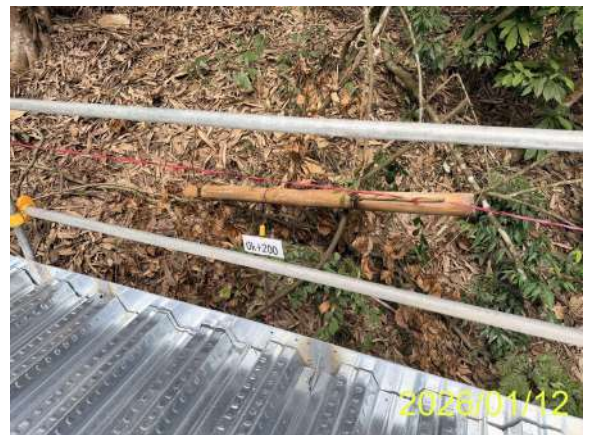
材料運輸造成之裸露地未覆蓋
