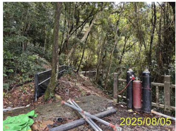
施工用鋼瓶等器材請妥善固定
