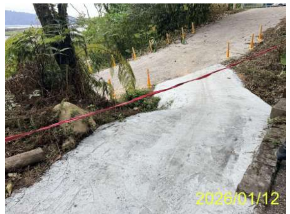
因施工而造成之便道已鋪設水泥，後續建議進行復舊
