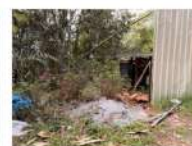
缺失-4 水泥砂漿逸散
