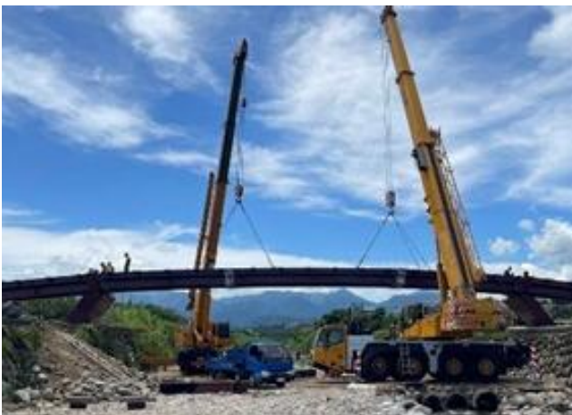
114年7月9日(施工進度約64.91%)，位於四線橋圳上方的高架自行車道開始施作，確認八留溪流暢通，無異物落入。
