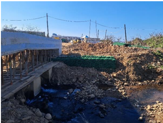
本團隊於 114/1/13 第四次抽查現地情形-山豬堀下坑跨橋便道施作。
