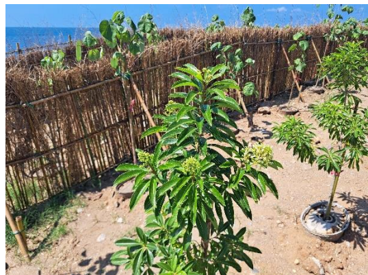
114 年 5 月 15 日(施工進度約 90%)，已補植若干種海岸木本植物，並以特製水盆減緩水分蒸散。
