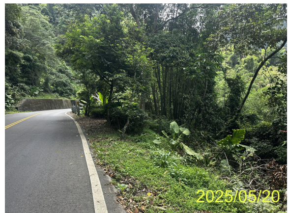
道路路肩較寬處，如需利用應設交維措施
