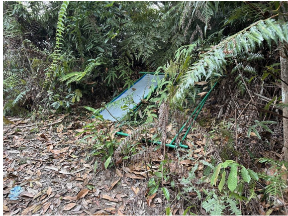
工區外發現部分施工物品散落。(20250423)
