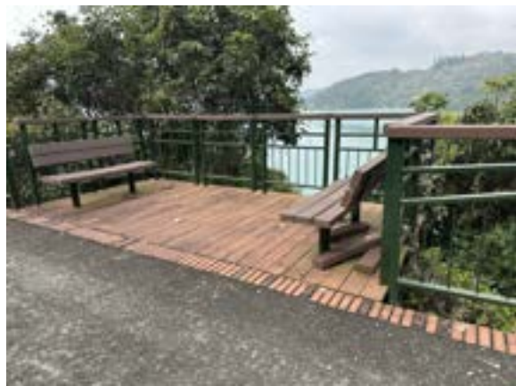
既有步道欄杆受損情形。(20250219)
