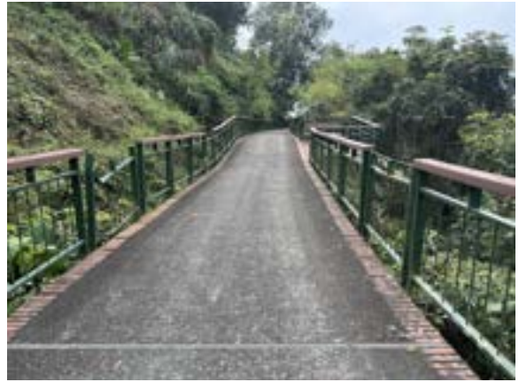
既有步道欄杆受損情形。(20250219)
