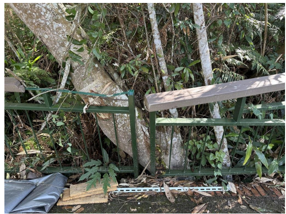
工區外既有施工步道因滑坡造成損害 (20250117)
