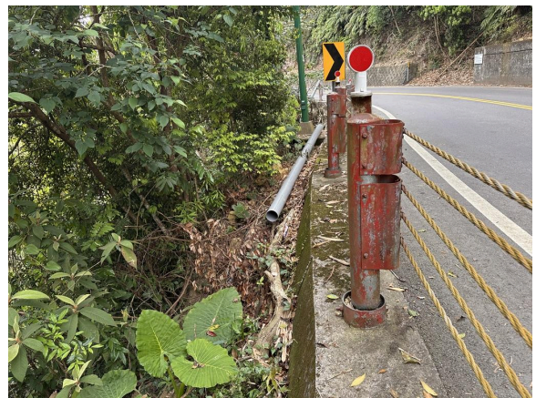
工區外發現部分施工物品散落。(20250423)
