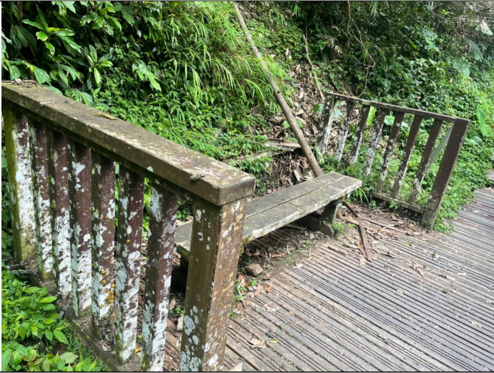
休憩平台毀損情形情形
