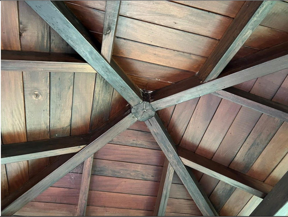
休憩涼亭之屋頂逢雨季會漏水情形
