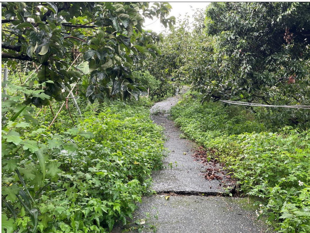
既有 RC 路面坡度過陡，且容易因下雨造成地面溼滑，導致行走困難及危險
