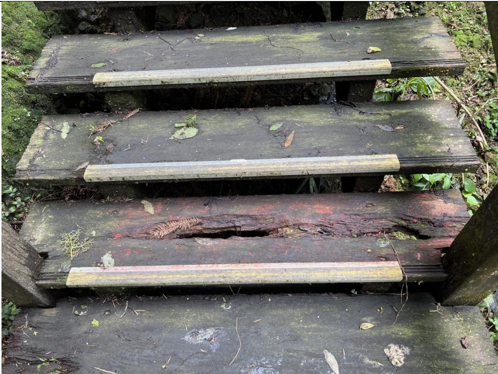
木馬棧道之面板破損毀壞情形
