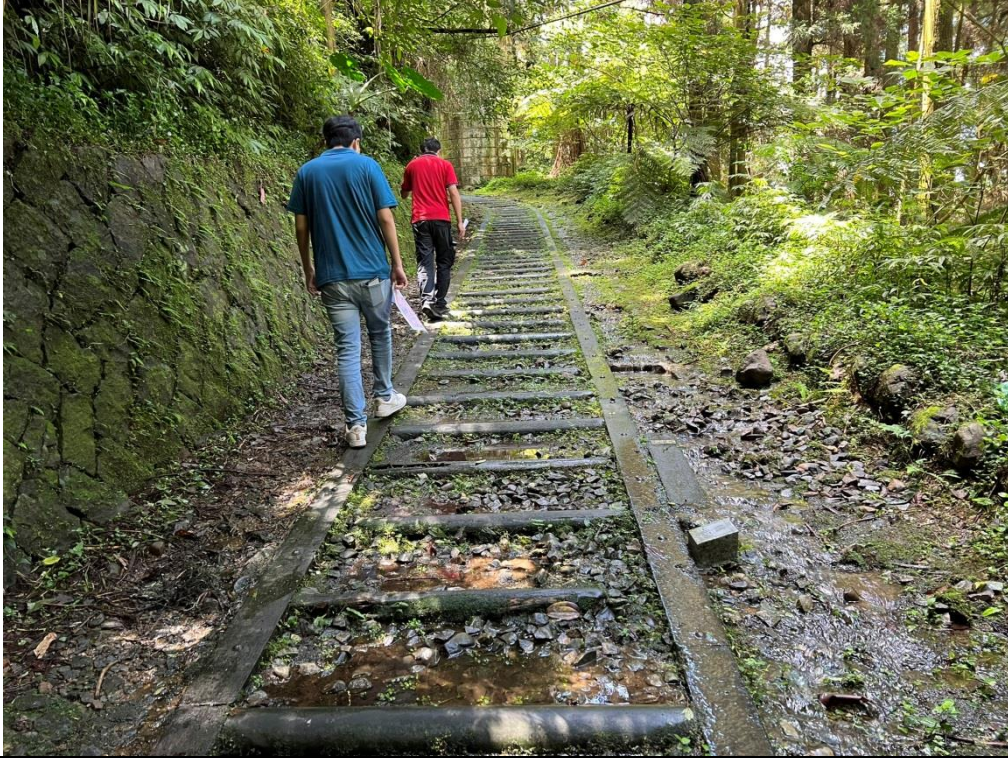
木馬棧道排水不良、步道溼滑情形
