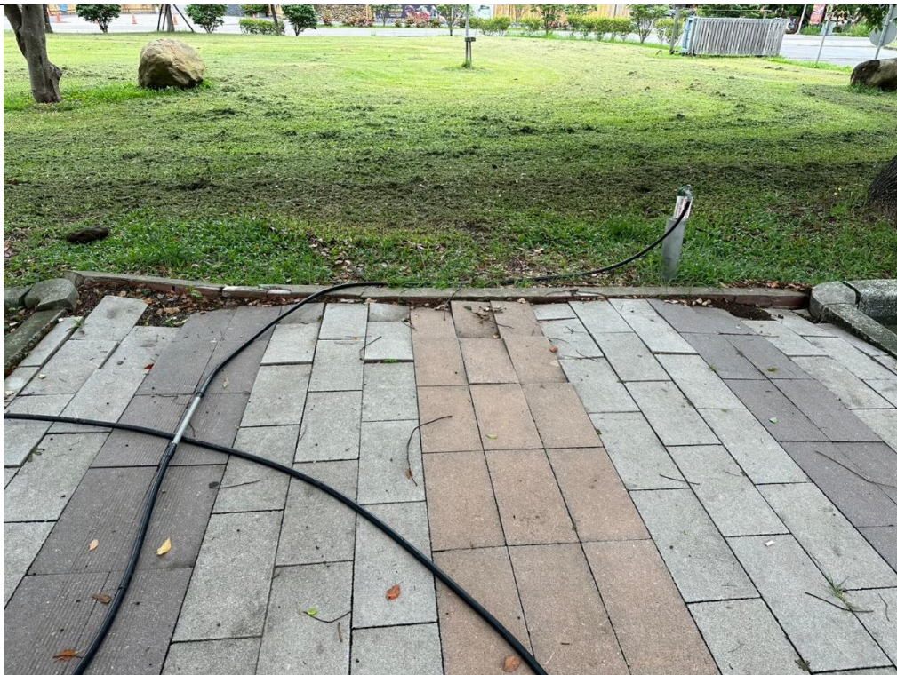
停車空間人行空間毀損情形
