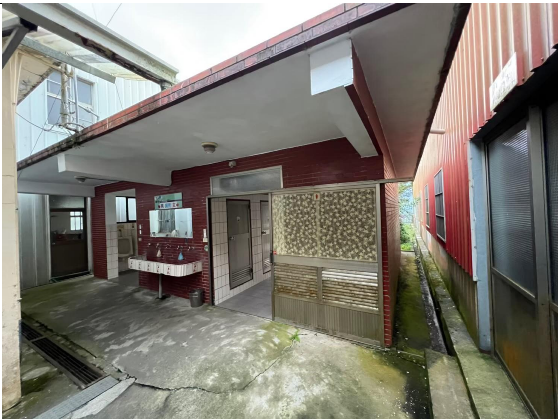
既有廁所設施老舊且整體規劃不符公共建築物衛生設備設計原則，進行優化
