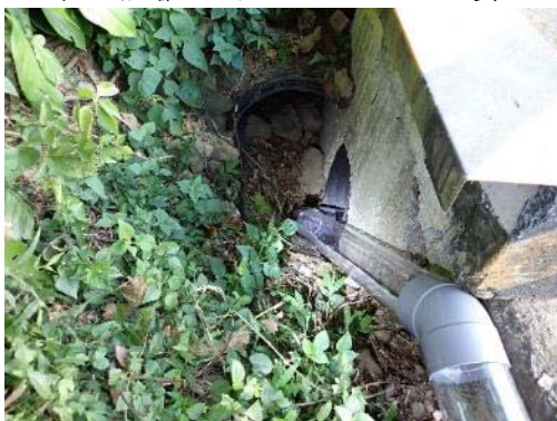
(e) 左側水管一路延伸至涵洞內
