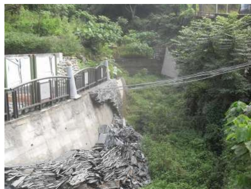
生態公園溪溝石板脫落
