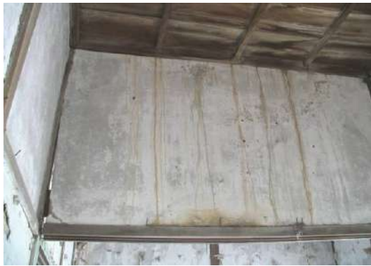
【照 22】L 區域屋面板破損滲水與建築傾斜現況
