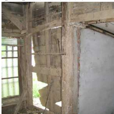
【照 5】一樓木柱構件因壁板破損受潮，而導致白蟻與真菌危害嚴重
