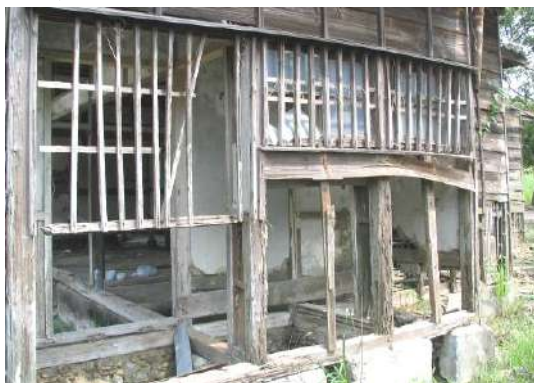
【照 26】N 區域壁板破損、木構件遭受白蟻與真菌危害現況
