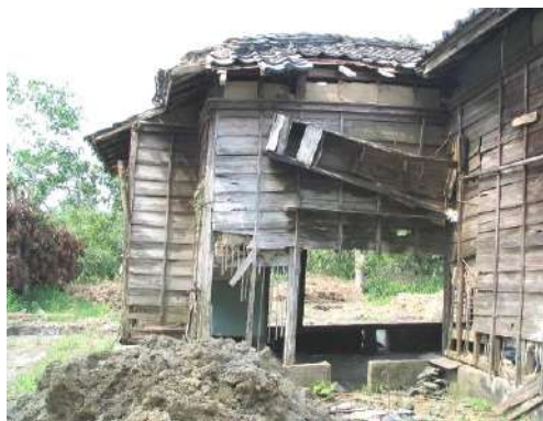
【照 27】N 區域建築物傾斜與壁板破損現況
