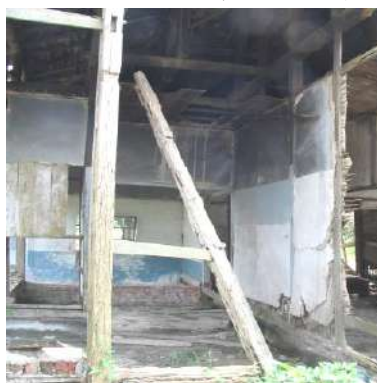
【照 15】H 區域壁板破損、木構件脫落以及木構件遭白蟻與真菌危害現況
