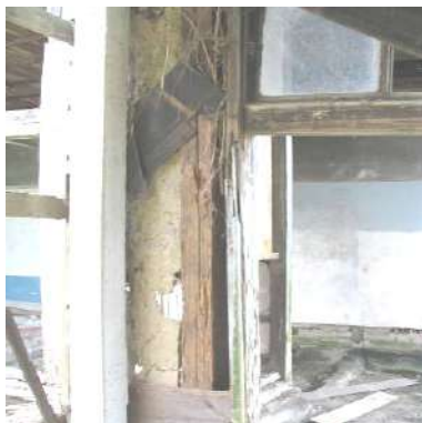
【照 10】板破損現況
