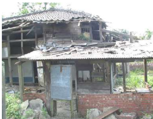
【照 9】C 區上部屋面板及構件損壞現況
