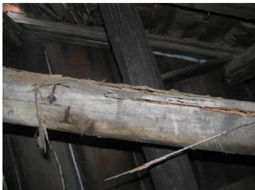
【照 1】屋架內木構件遭受白蟻蛀蝕嚴重
