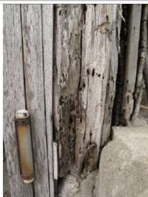
5. 門柱受生物性劣化*
