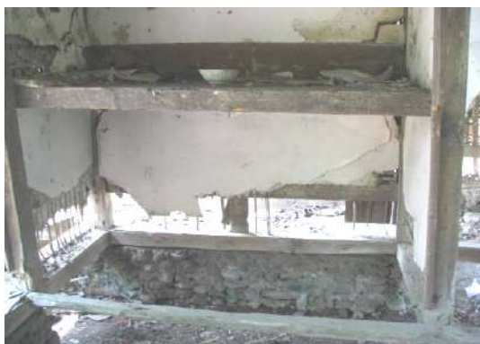
【照 16】I 區域壁板破損及木構件遭白蟻與真菌危害現況
