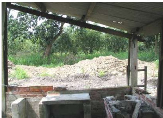
【照 8】A 區壁板破損、構件損壞現況
