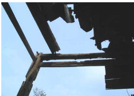
【照 10】D 區屋面板破損、壁板破損及構件遭白蟻與真菌危害現況
