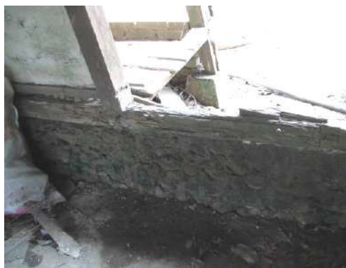
【照 17】I 區域木構件遭白蟻蛀蝕現況
