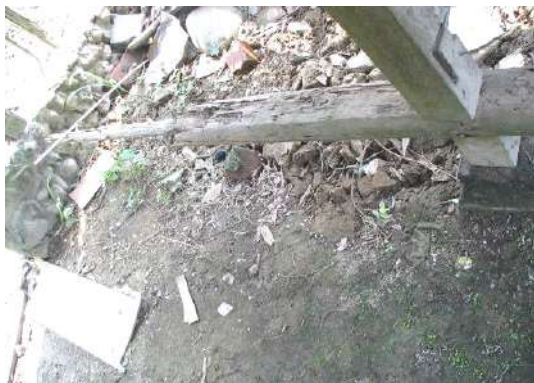
【照 20】K 區域部分壁板佚失、壁板破損、構件遭受白蟻與真菌危害現況
