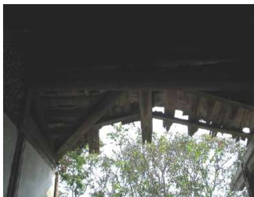
【照 25】M 區域屋面板破損與建築傾斜現況
