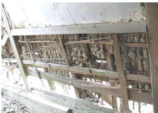
【照 24】M 區域壁板破損、木構件遭受白蟻與真菌危害現況
