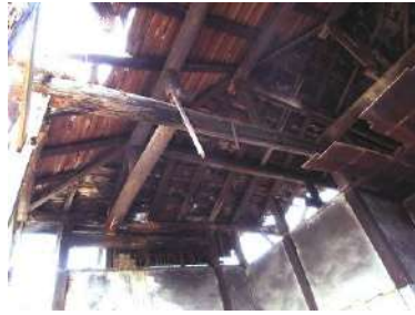
5. 桁架腐朽及開裂*
