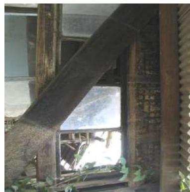
【照 9】B 區構件脫落現況
