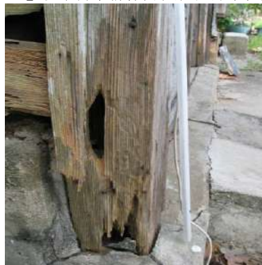
【照 6】一樓外側壁板破損使木柱構件受天候劣化影響，木質構件因受潮而導致生物性因子危害
