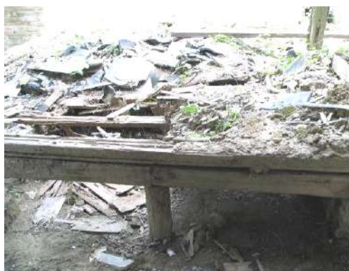
【照 13】F 區部分區域倒塌、壁板佚失、部分構件佚失以及構件遭白蟻與真菌危害現況
