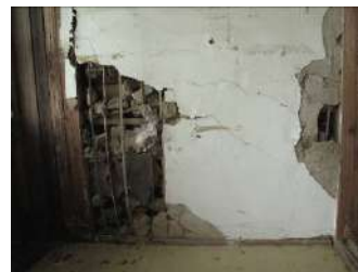
12. 壁面損壞，小舞 注3 露出*
