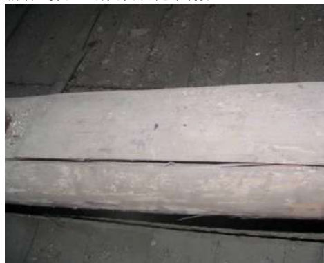
【照 4】屋架內木構件因吸脫濕而導致開裂
