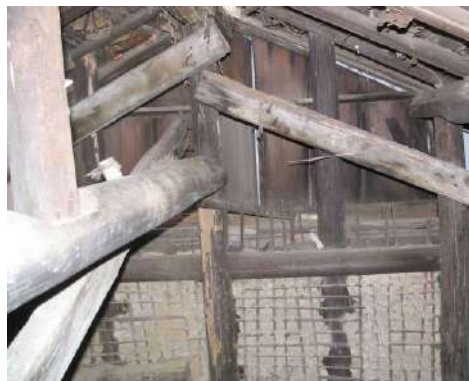
【照 2】屋架內因屋面板破損，而導致下方構件遭受白蟻與真菌危害嚴重
