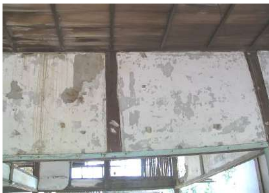
【照 18】I 區域屋面板破損滲水及建築傾斜現況
