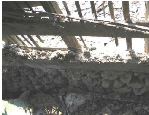
【照 23】L 區域壁板破損、木構件遭受白蟻與真菌危害現況
