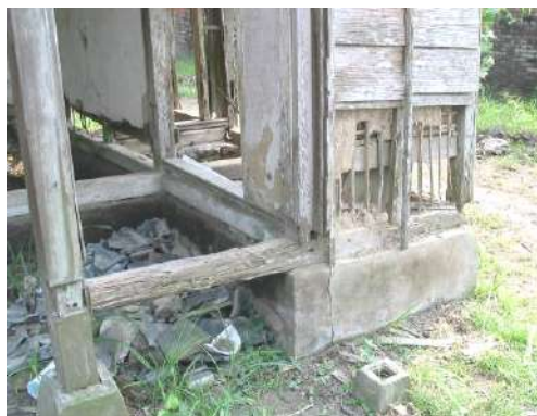
【照 19】J 區域壁板破損、木構件遭白蟻與真菌危害現況
