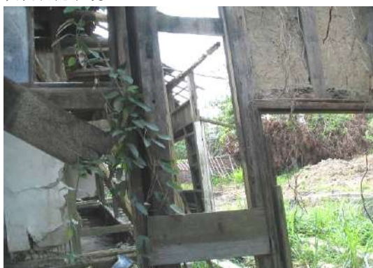
【照 12】E 區壁板破損、構件脫落、木質材料遭白蟻以及真菌危害現況
