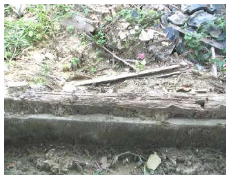
【照 11】板佚失及構件遭白蟻蛀蝕現況
