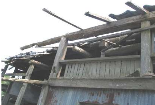
【照 14】G 區域建築傾斜、屋瓦破損、屋面板破損、壁板破損及木構件遭白蟻與真菌危害現況
