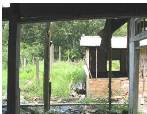
【照 11】D 區壁板破損及構件遭白蟻蛀蝕現況
