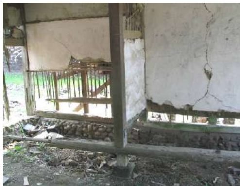
【照 21】K 區域壁板破損、建築傾斜、木構件遭受白蟻與真菌危害現況
