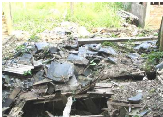
【照 12】區大部分區域倒塌且構件佚失現況
