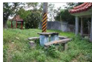
設施老舊破損
