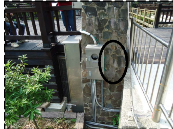
配電箱安裝位置
