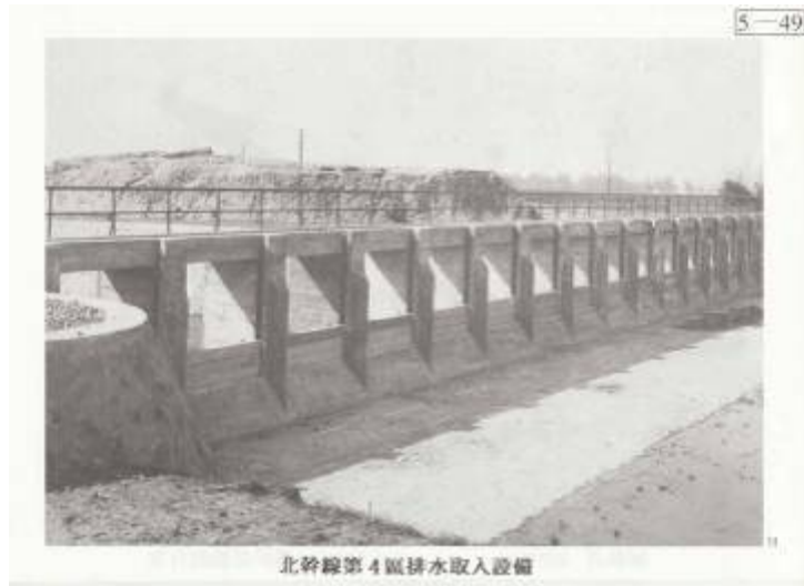
圖 2-11 北幹線排水設備 32 。
