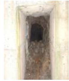
井垵防空洞坍塌
